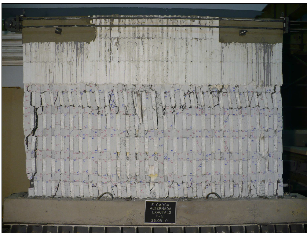
Foto 6. Nivel de daños del muro 2 para el estado límite "Estado Final" .
