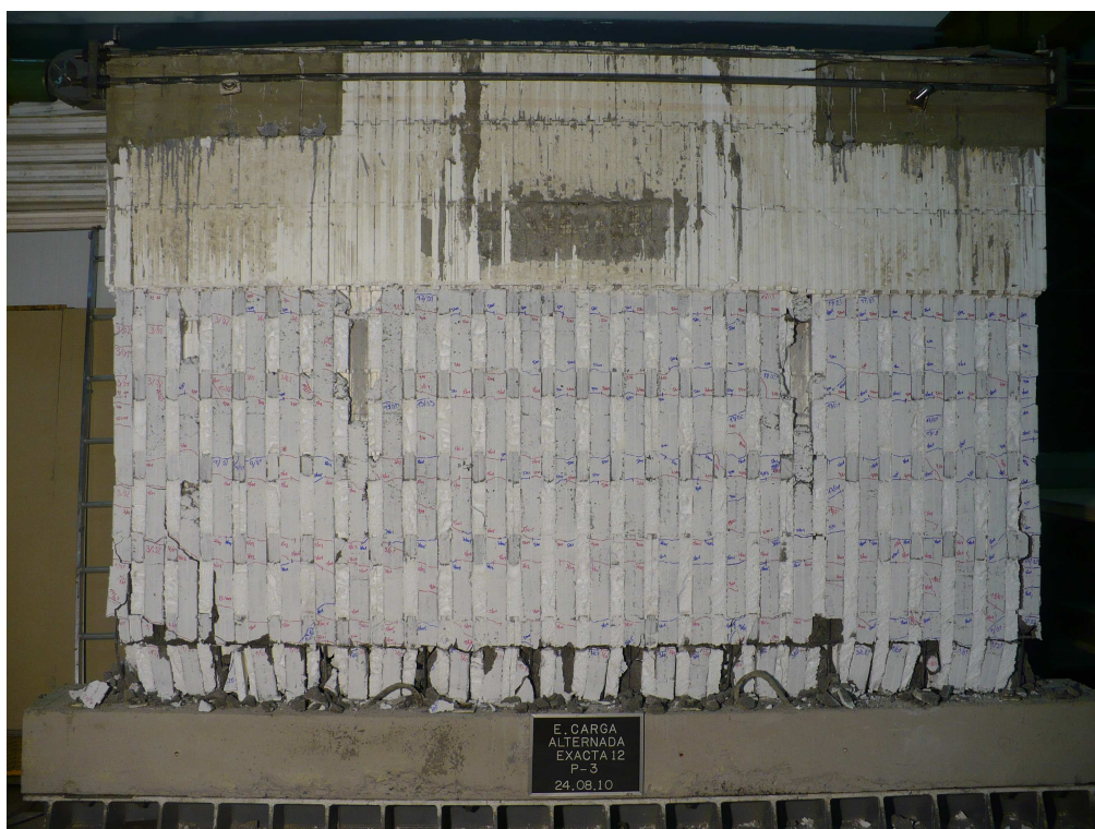
Foto 8. Nivel de daños del muro 3 para el estado límite " Estado Final ".
